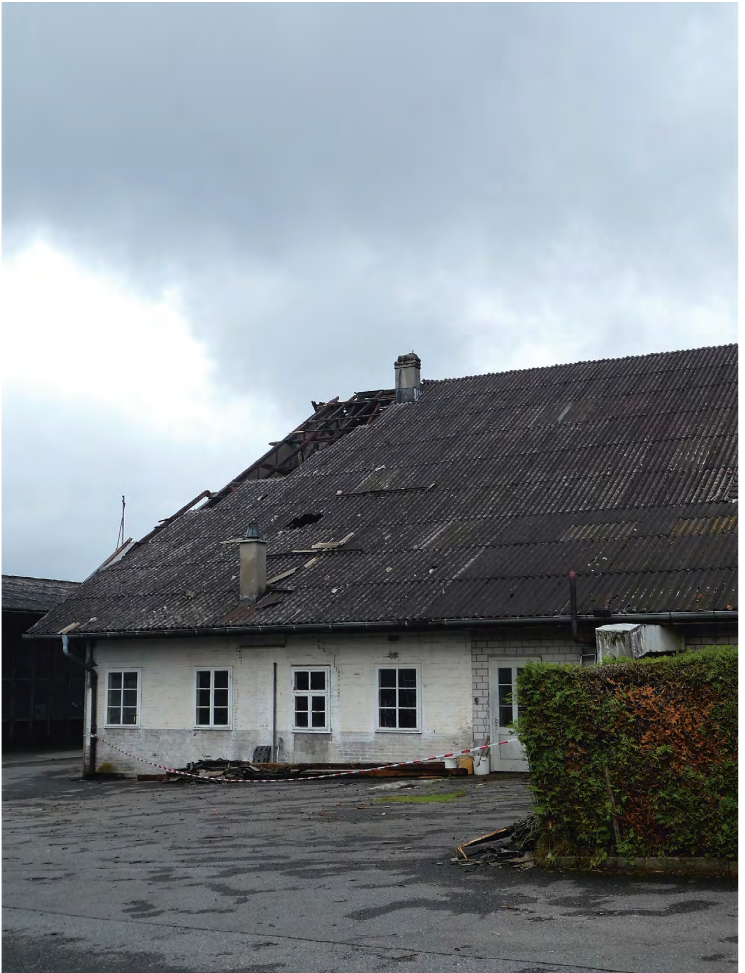
Sturmschäden bei der ehemaligen Brennerei Wyss vom 28. Juni 2021. Foto: Lu
